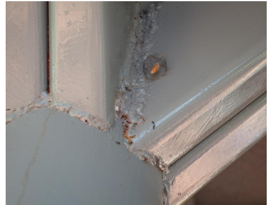
รอยเชื่อม fillet weld ที่ไม่สมบูรณ์
