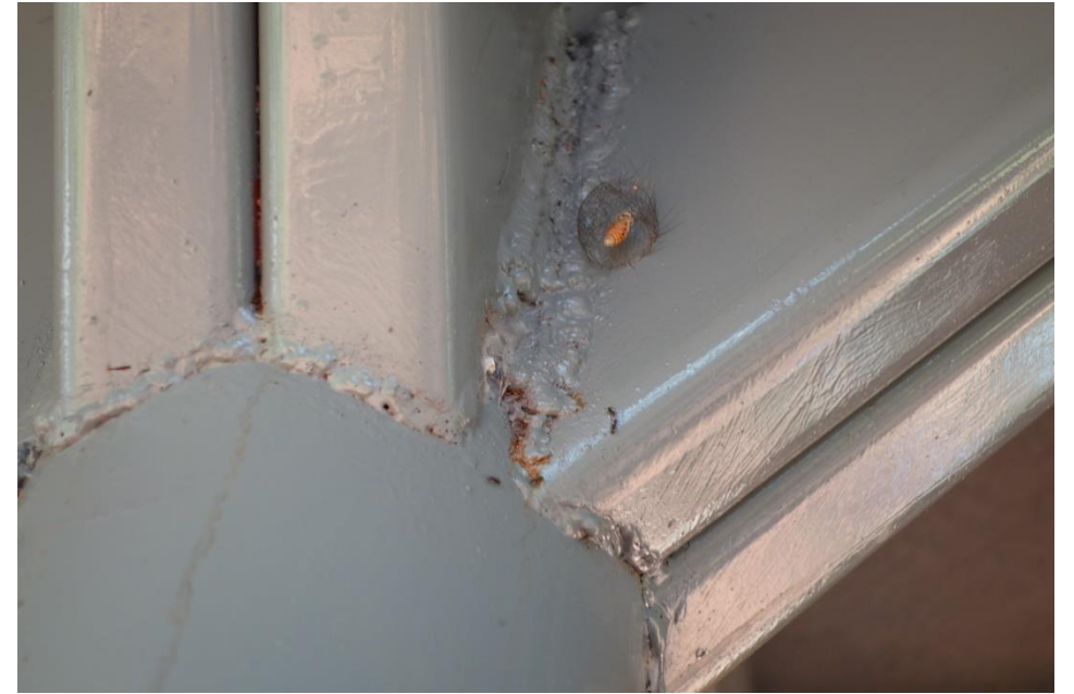
รอยเชื่อม fillet weld ที่ไม่สมบูรณ์
